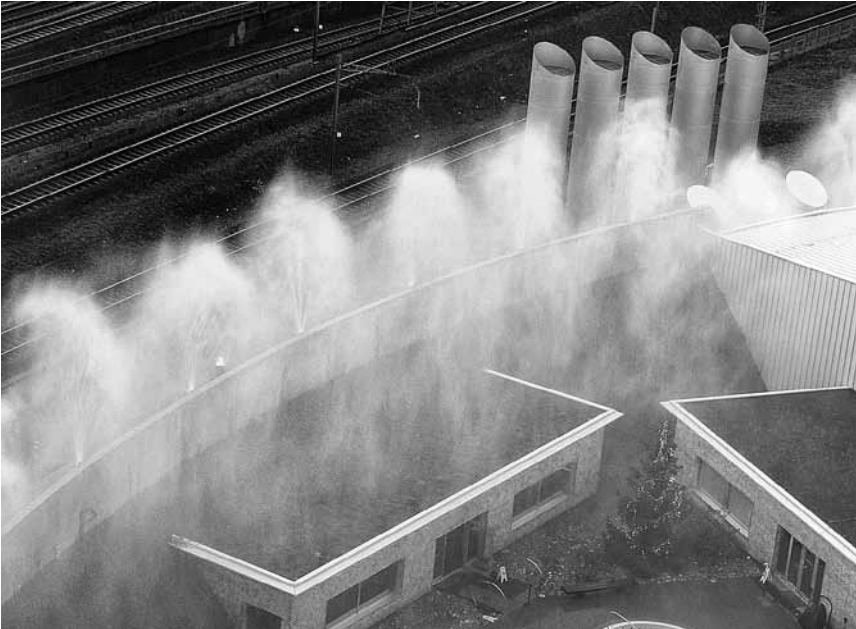
▲ Wasservorhang gegen das Eindringen toxischer Gase
