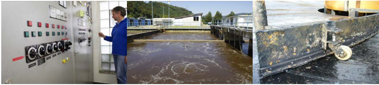
Abbildung 2: 40jährige ARA Frenke 3 in Bubendorf (Anlagensteuerung, Belebungsbecken, Bsp. Zustand maschinelle Ausrüstung)
