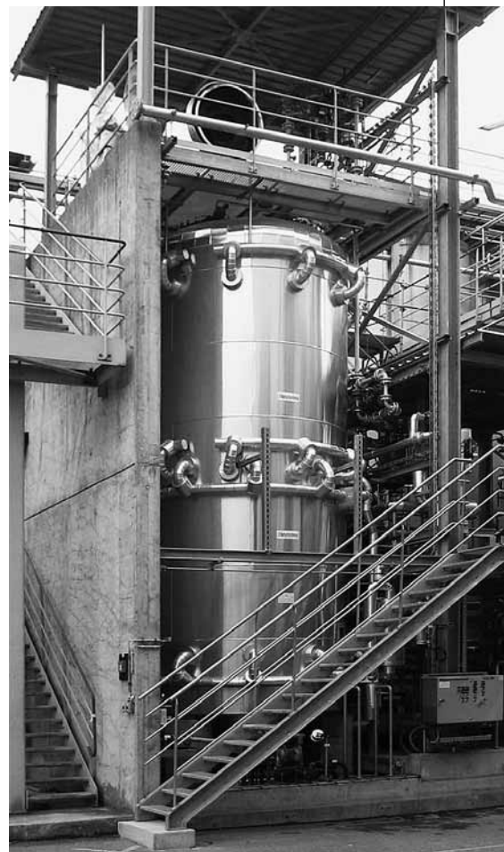
▲ Methylchlorformiat Tank L18 mit Sicherheitsmassnahmen
