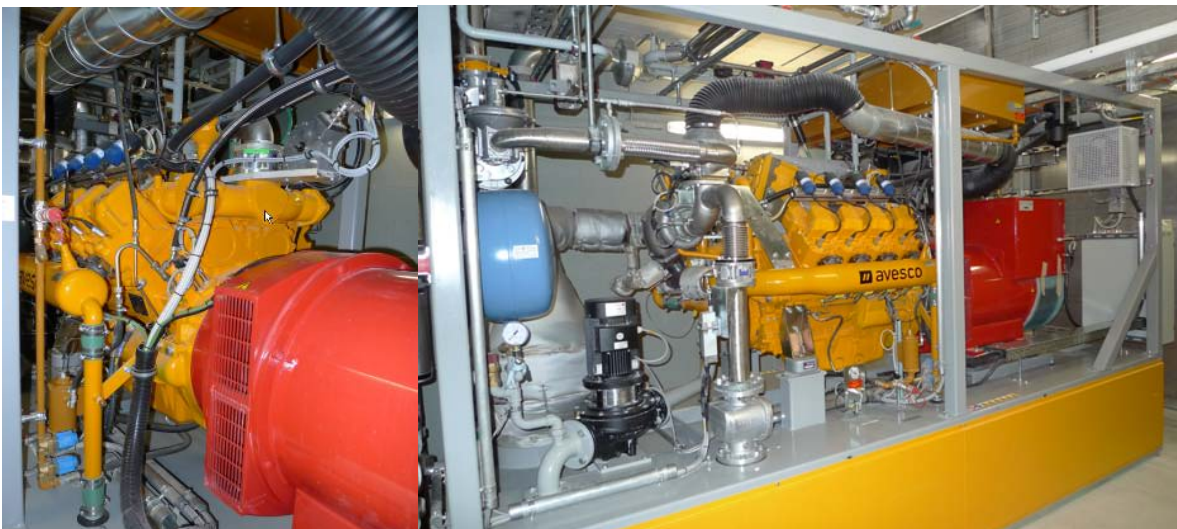
Abbildung 1: Neues Blockheizkraftwerk (BHKW) der ARA Birs (Inbetriebsetzung 2009) zur Stromproduktion.
