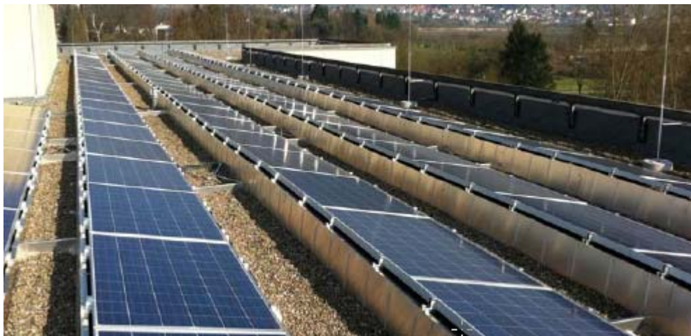
Abbildung 5: Aufgeständerte, in Reihen verlegte Solarmodule (Beispiel).
