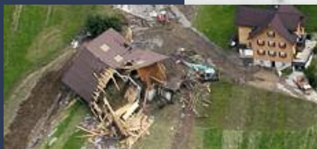
Die verheerenden Unwettern vom 22. August 2005 richteten im Kanton Nidwalden an 1300 Gebäuden Schäden an.
