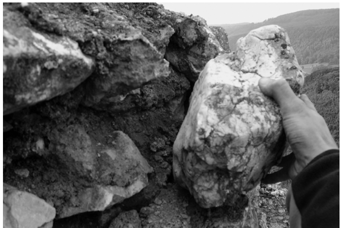
Ruine Pfeffingen. Lose Steine auf den Mauerkronen sind eine grosse Gefahr für die Besucherinnen und Besucher der Burg.
