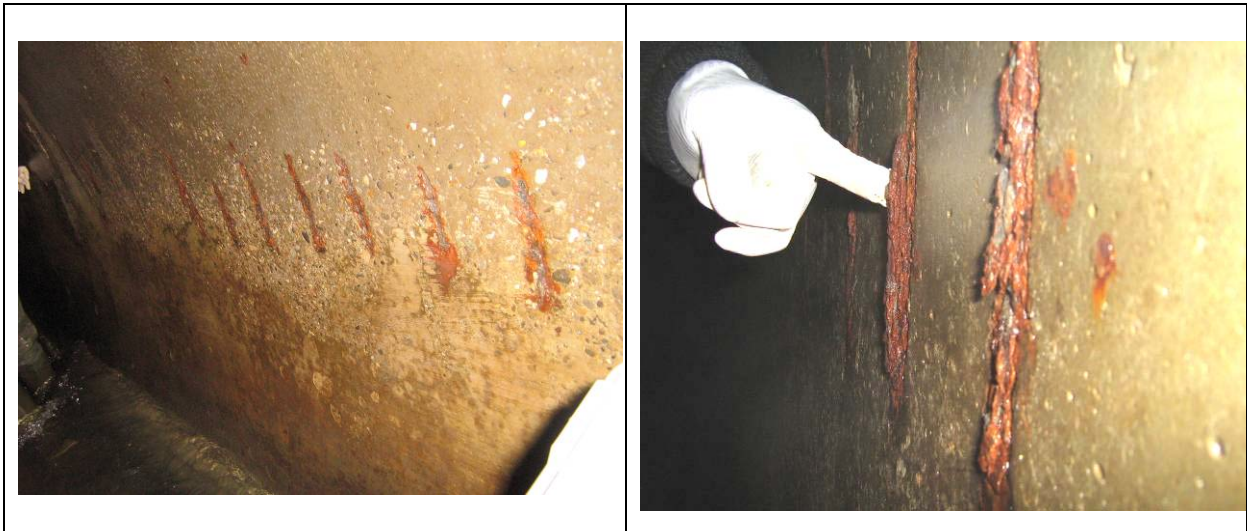
Abbildung 3 Angerostete Armierung (zum Teil praktisch Auflösung)
