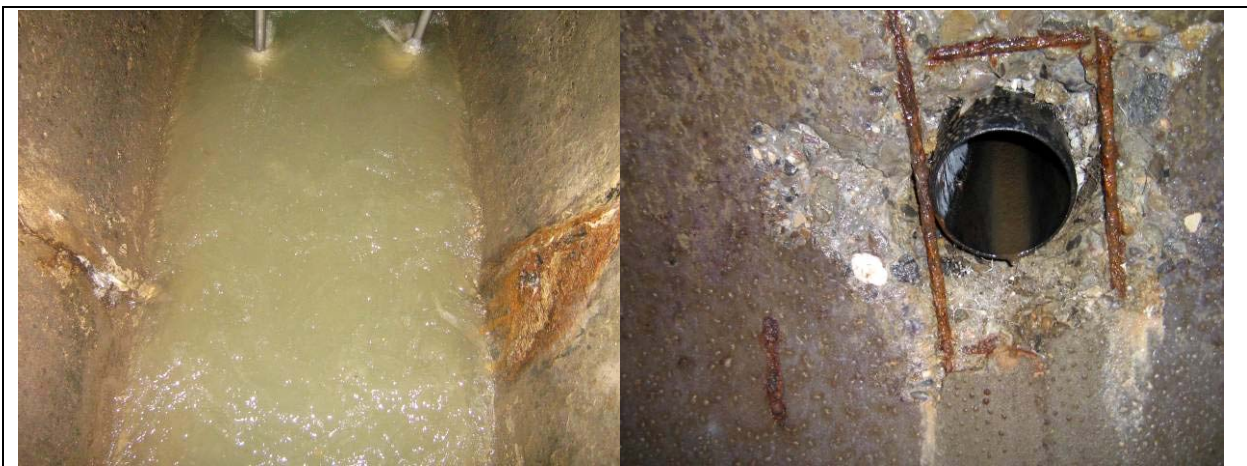
Abbildung 4 Defekte Fuge mit Wassereintritt und Schaden durch unsachgemässen Anschluss
