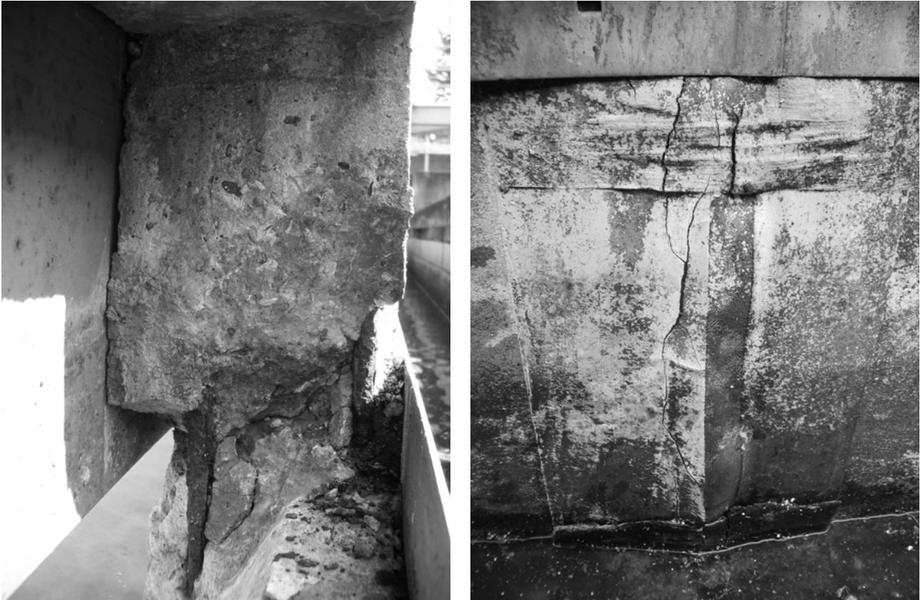
Abbildung 2 Schäden an Tragkonstruktion und Fugen
