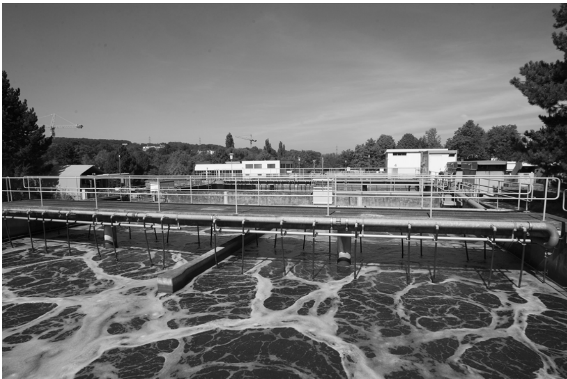
Abbildung 1 Abwasserstrasse ARA Ergolz 2
