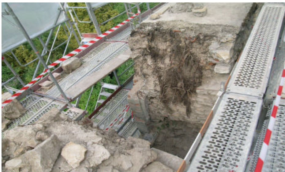
Beim Abbau der Mauerkrone Süd wird der Umfang der Schäden deutlich.
