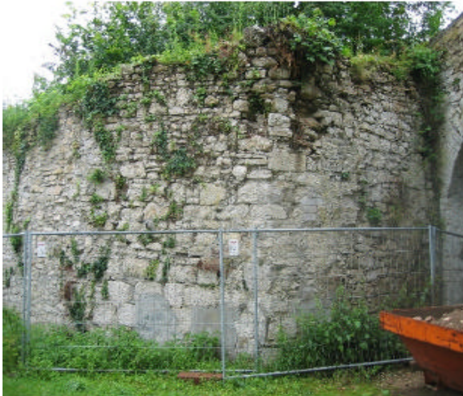
Die stark durchwachsene, einsturzgefährdete Zugangsbrücke ist abgesperrt.
